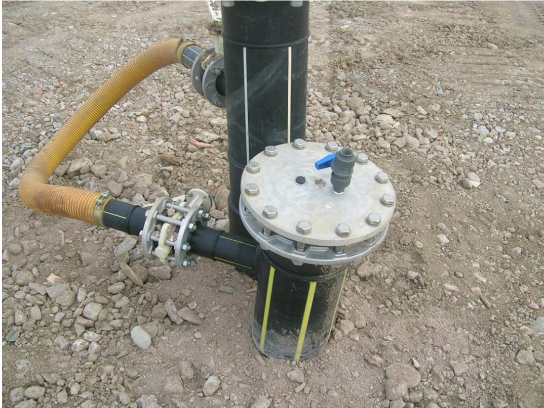
FIG. 4.5 Particolare di una testa di pozzo
