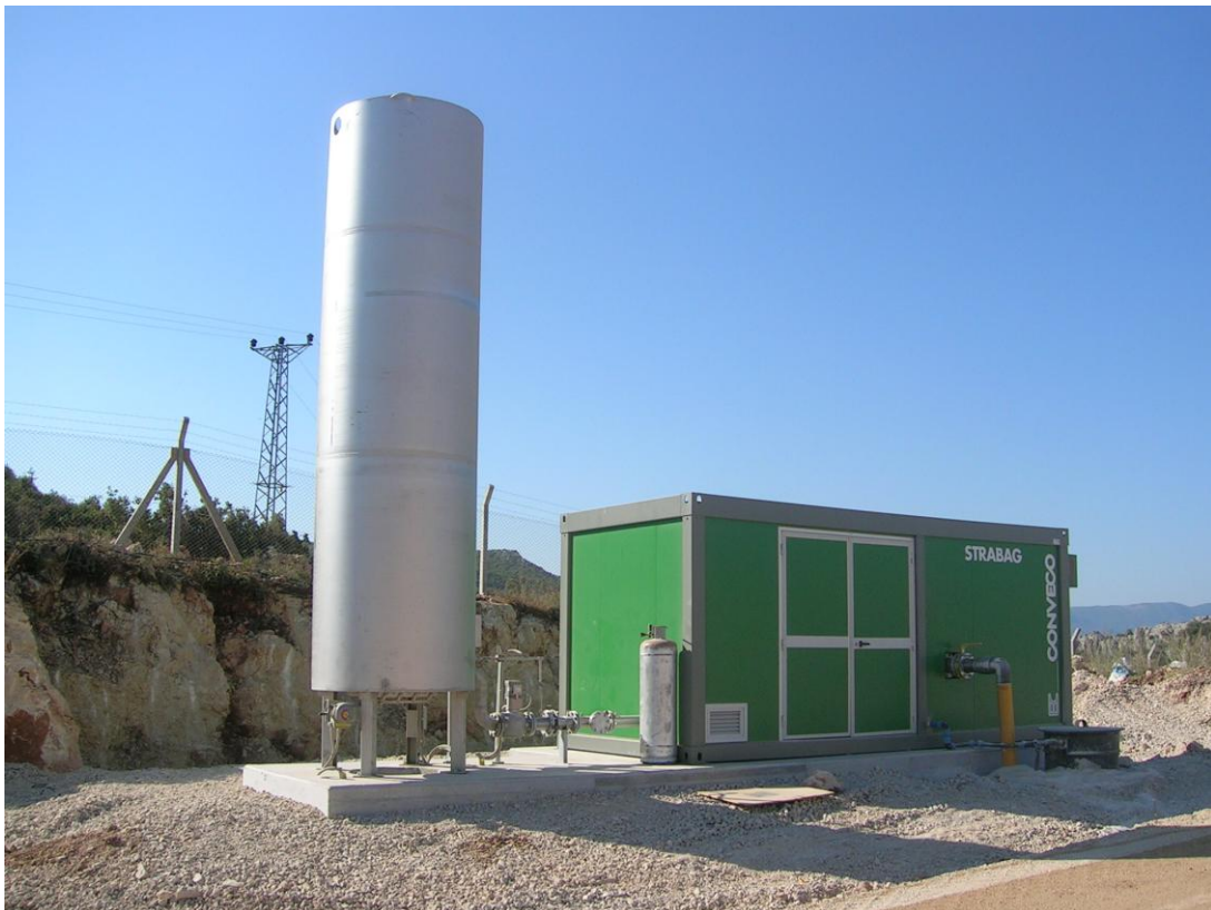
FIG. 3.4 Torcia ad alta temperatura e centrale di aspirazione in container
